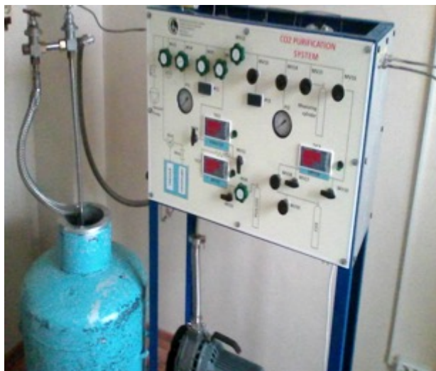
Установка по очистке CO_2
