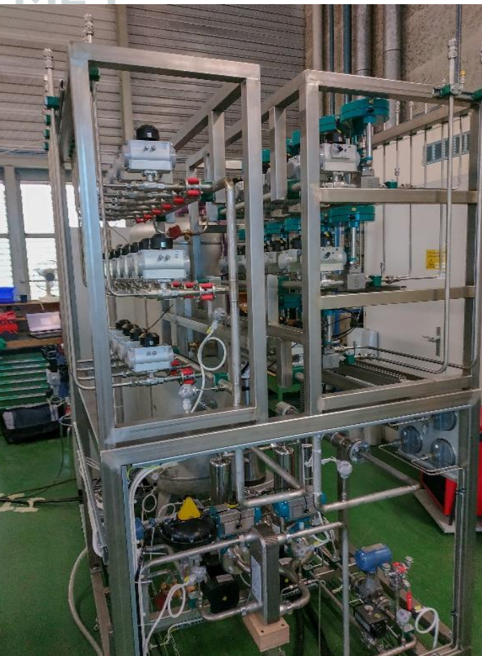
Клапаны дистанционного управления потока воды в охлаждающих цепях Внизу теплообменник
