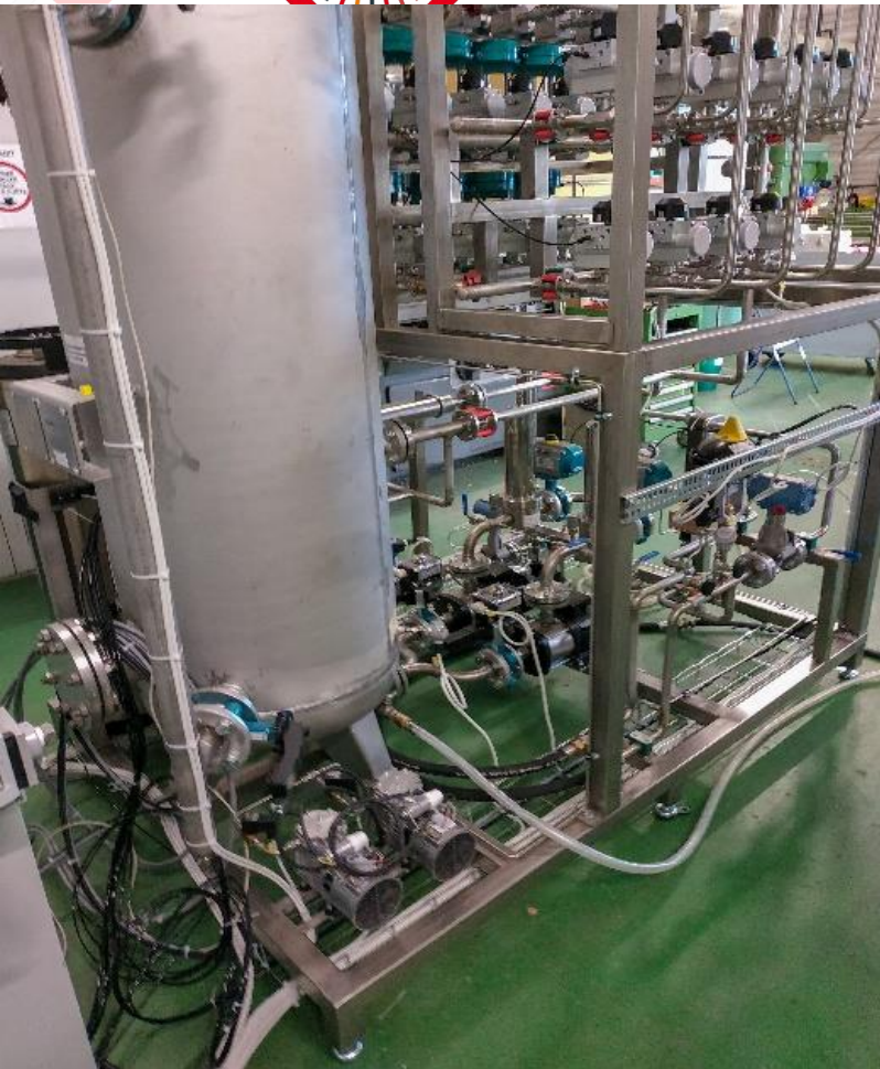
Накопительный резервуар и циркулярные насосы
